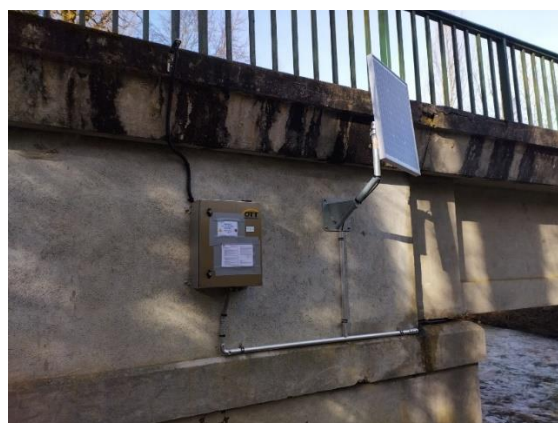
Figure 27: Photo de la station hydrométrique installée au lieu-dit Chosol à Cruseilles au point nodal US02
