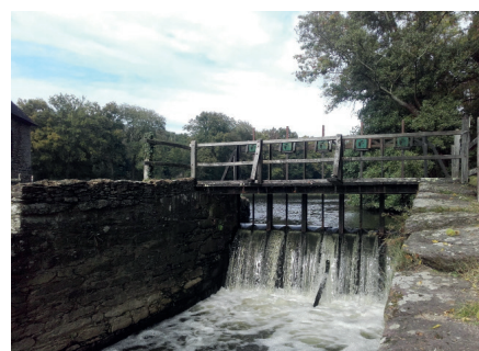
Photo 5 : Aménagement servant à maintenir une hauteur d'eau (batardeau)
